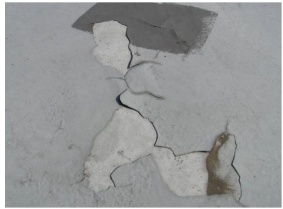
写真 2.1.2 防水層の破損の事例
